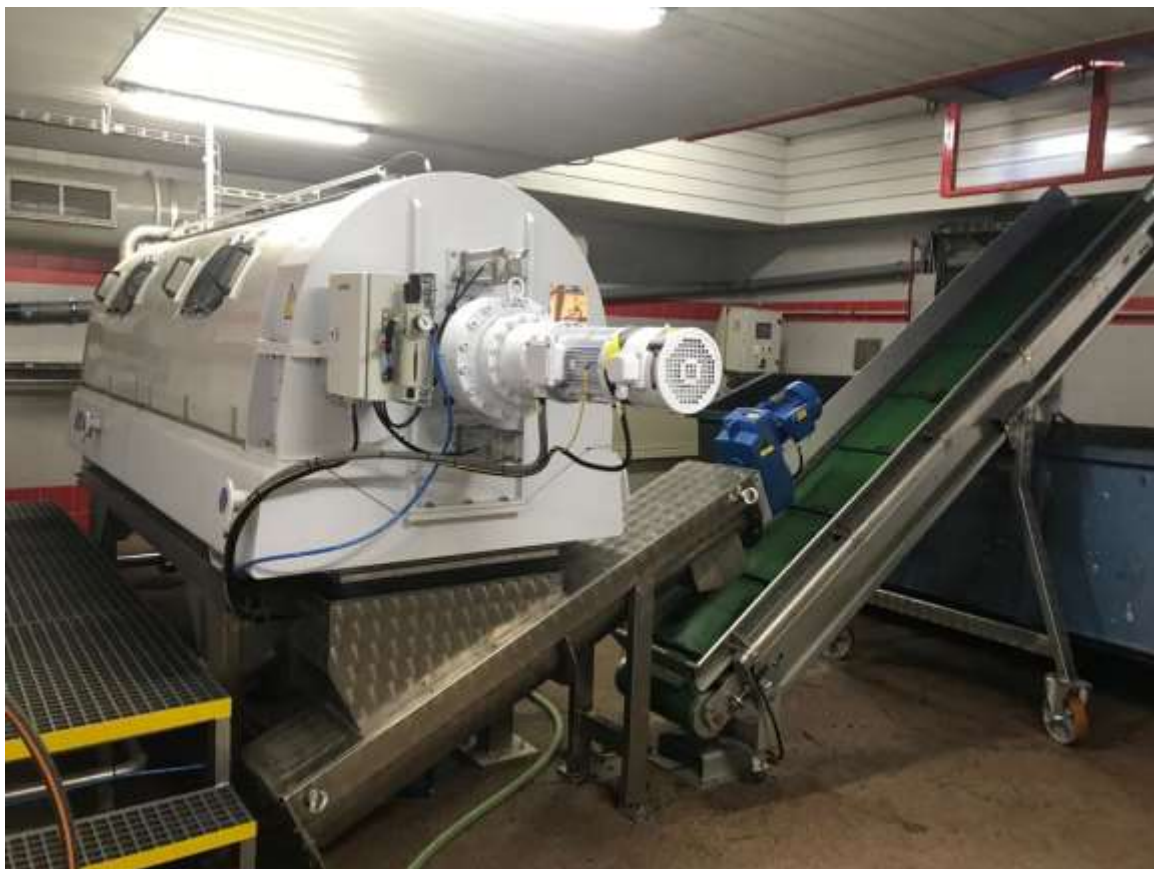
Kalová koncovka – šnekolis k odvodnění kalu včetně pásového dopravníku kalu
