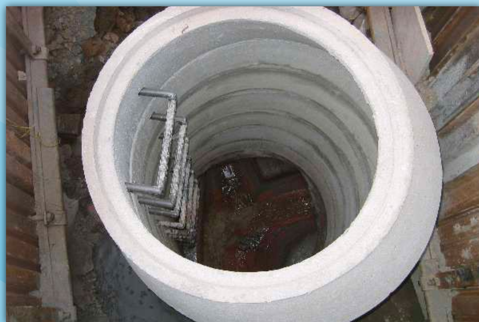
Kanalizační šachty jsou také umístěny na každé přípojce k napojeným sousedním objektům.
