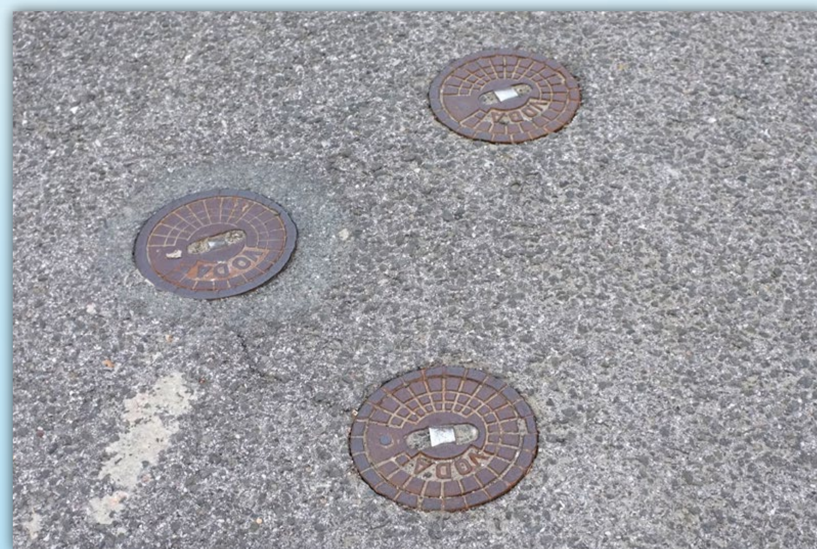
Domovní uzávěry vody - každý dům má svůj uzávěr vody pro případ poruchy nebo opravy v domě. Uzavírací ventil se ovládá dlouhou tyčí, která je pod víčkem.
