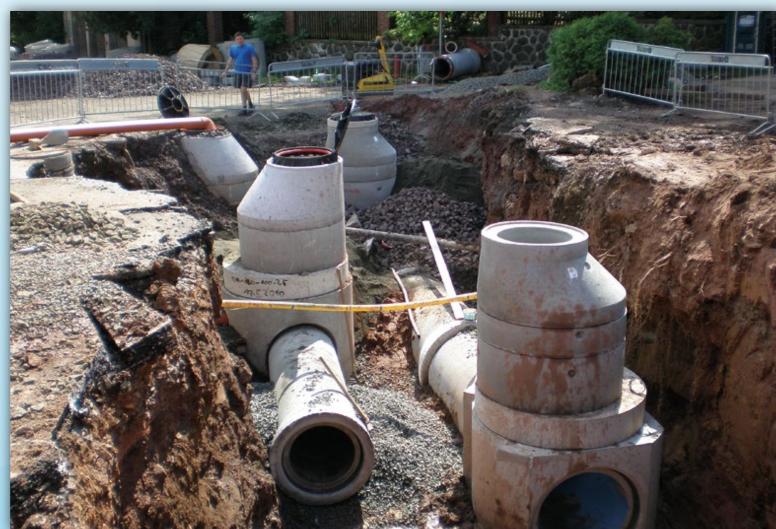
Kanalizační šachty - slouží k prohlídce kanalizace a k jejímu čištění.
