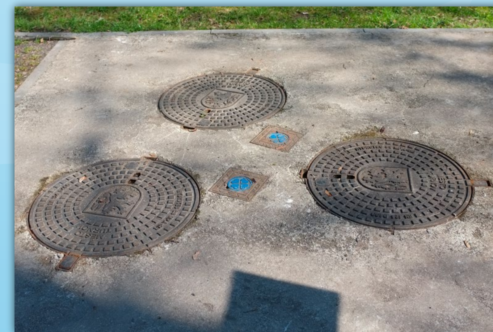
Čerpací stanice odpadních vod – z Bukoviny, Dolánky a Kobylky
