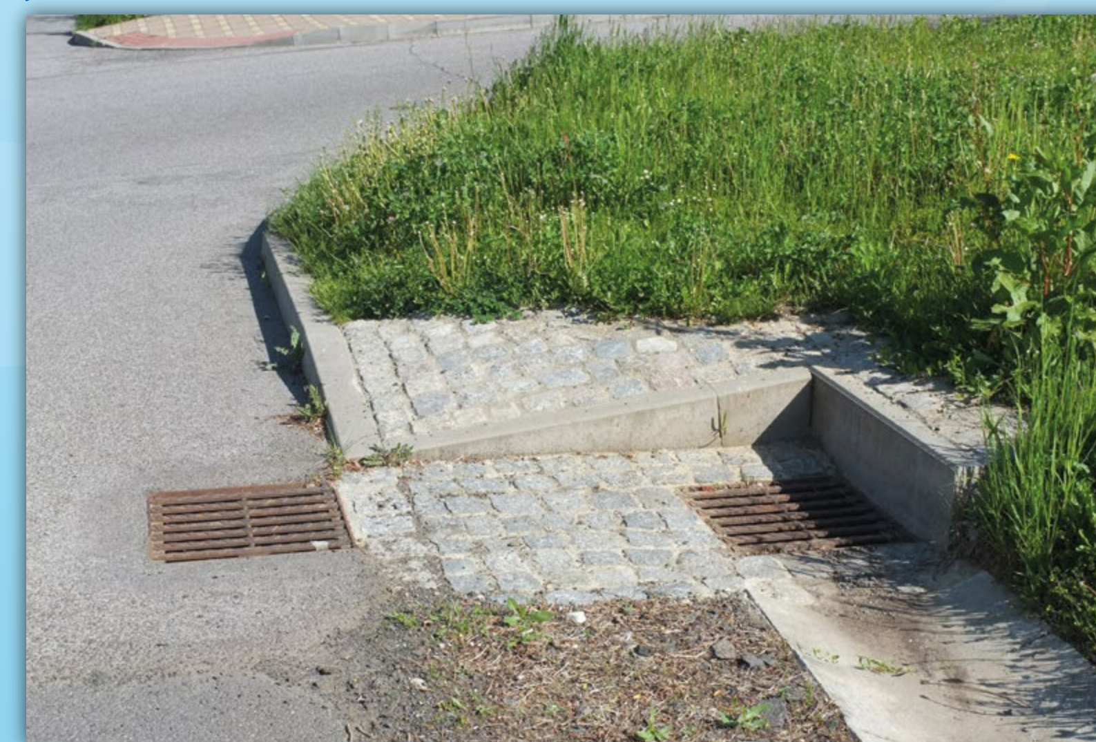
Ovedení srážkových vod z terénu - na křižovatce 100 m za Vámi jste minulí dvě vpusti vedle sebe, které však neodvodňují ulici. Z nezastavěného hrstičského pole přiteče při silných deštích tolik vody, že ji příkop nestačí odvádět a přetékající vodu musíme nasměrovat do kanalizace, protože by jinak zaplavila silnici a okolní domy.
