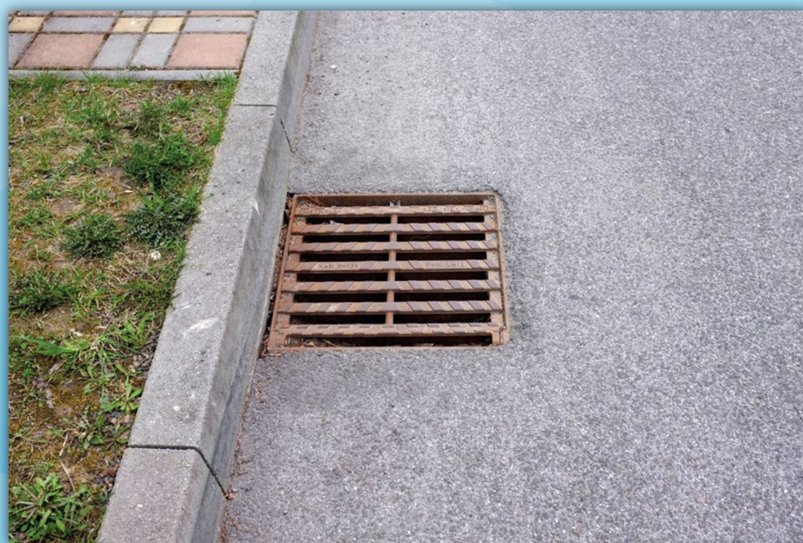
Uliční vpust' - odvádí vodu z povrchu ulic do dešťové kanalizace.
