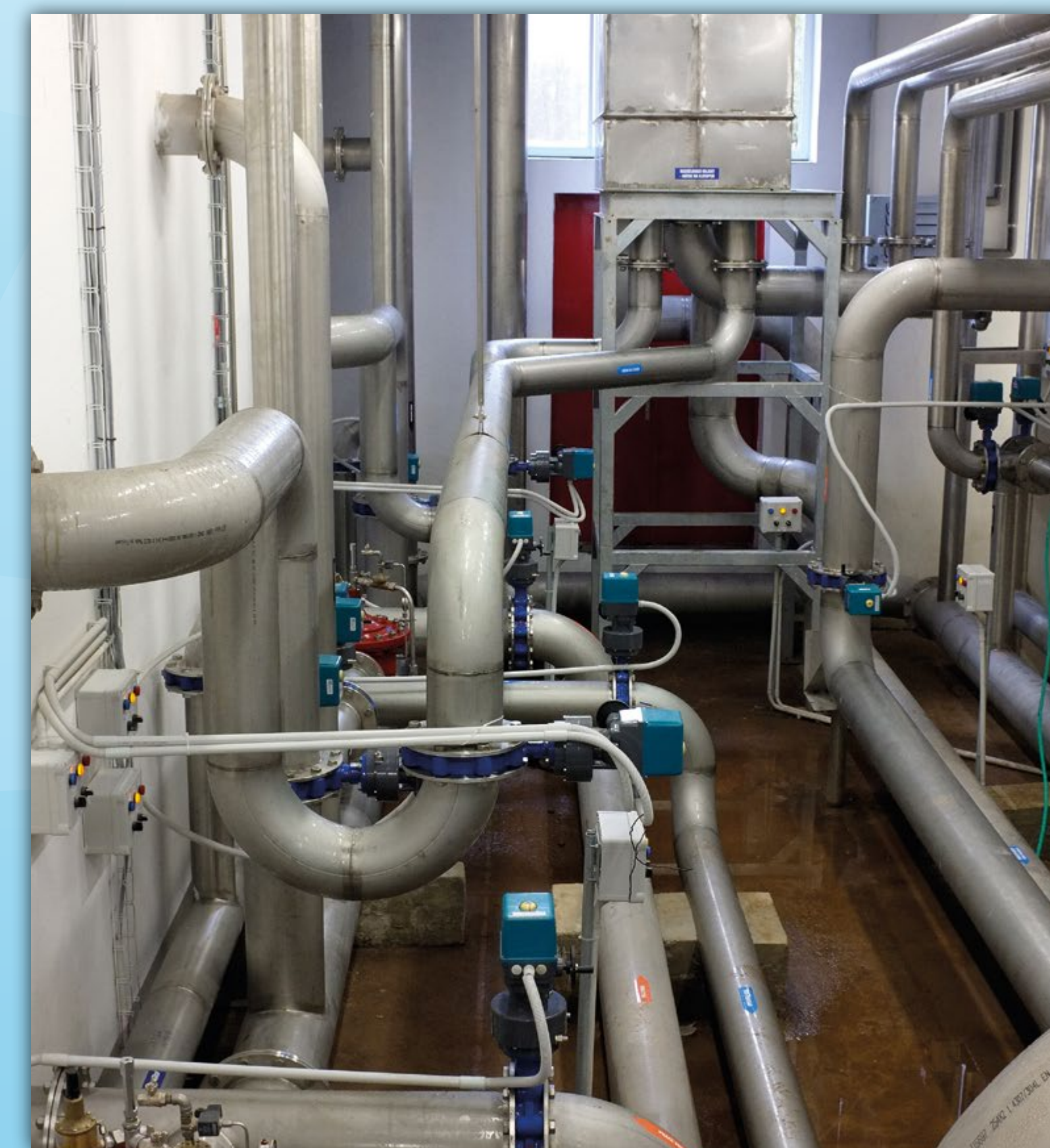
Úpravna vody - Příkrý na Semilsku
